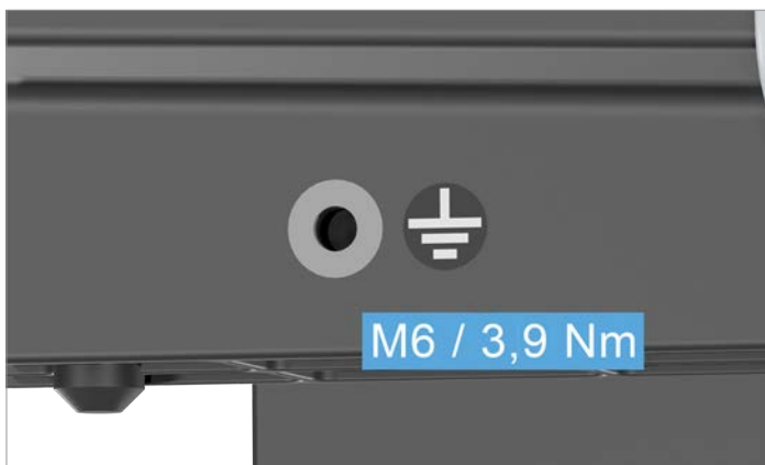
Fig. 5.14 : Vis de mise à la terre située sur le pied gauche de l'onduleur
